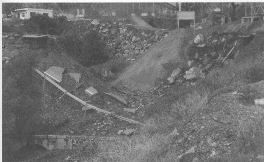
Efectes de l'aiguat de l'octubre de 1994 a la carretera del coll d'Alforja.
