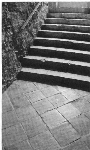
Detall de paviments originals apareguts sota la runa
