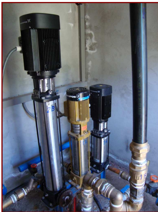
FIG 16. VISTA INTERIOR DELS EQUIPS DE BOMBAMENT
