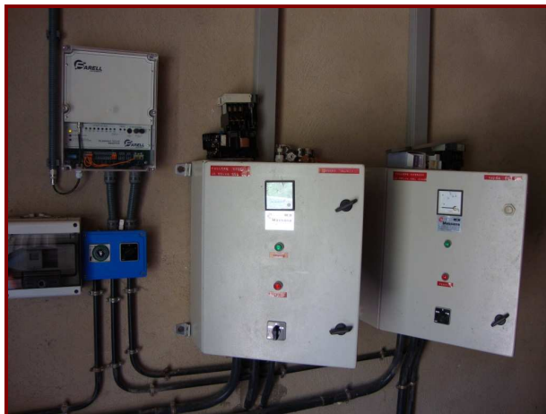
FIG 36. DETALL DE SISTEMA INFORMÀTIC DE TELECONTROL I TELECOMANDAMENT
